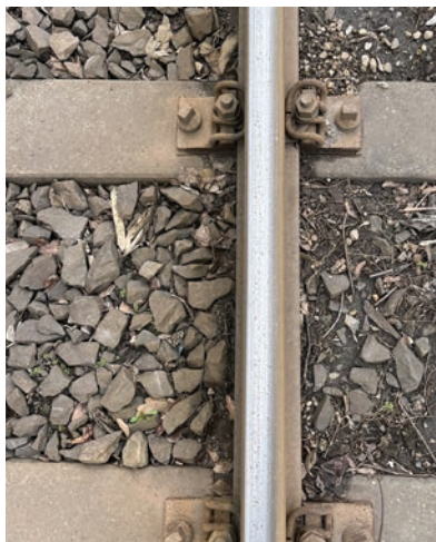
3. ábra. A vizsgált szakasz állapota. (Saját fotó)
